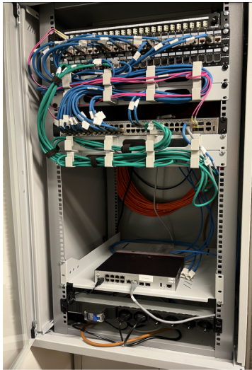
Armadio rack Sede Dunant, P.T
